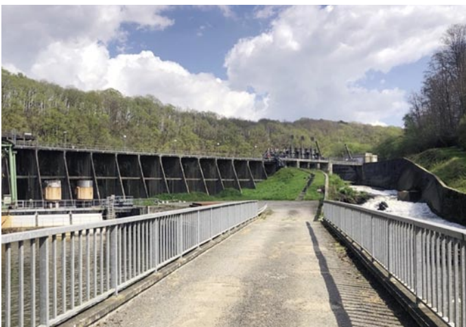
Der Staudamm von La Roche-Qui-Boît (Eigentum der EDF), mit dem Überlauf auf der rechten Seite und dem Kraftwerk auf der linken Seite.
